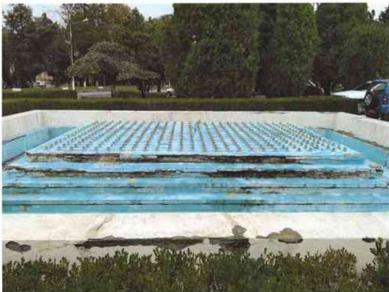
Foto: Degradări la nivelul structurii ansamblului
