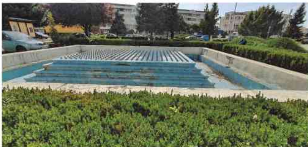
Foto: Degradări la nivelul finisajelor
