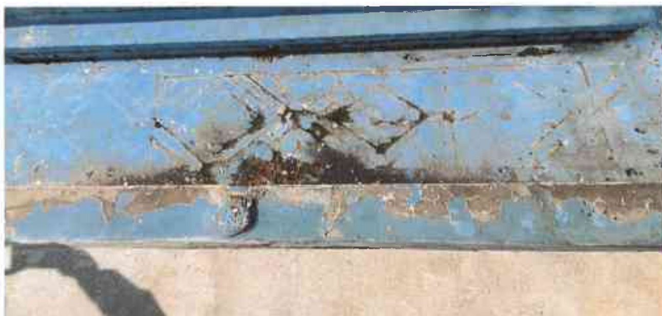
Foto: Degradări de ordin biologic
