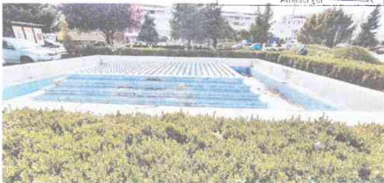
Foto: Degradări la nivelul finisajelor
