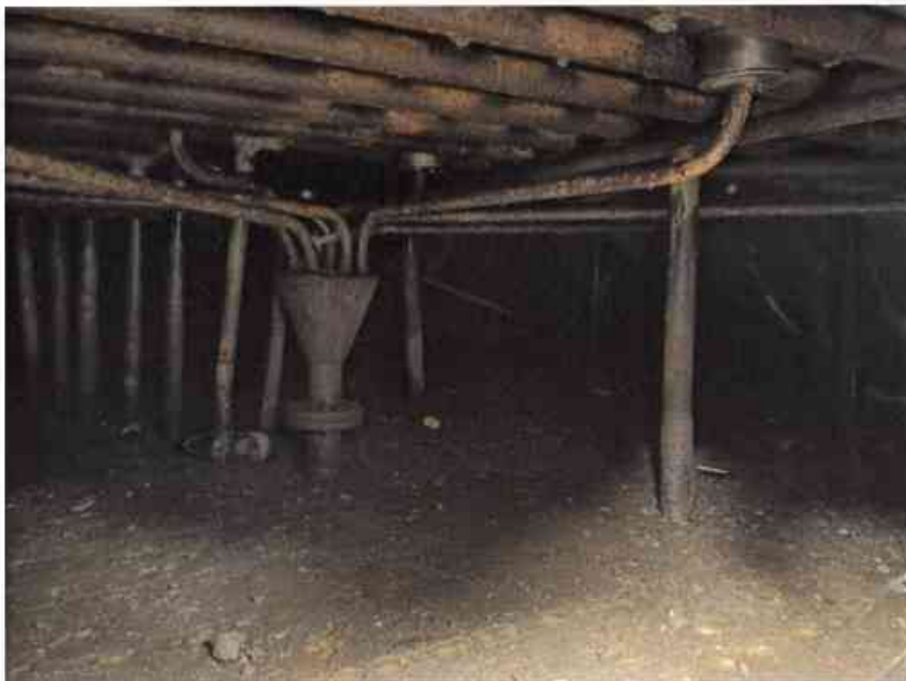
Foto 12 – Detaliu degradări instalații
