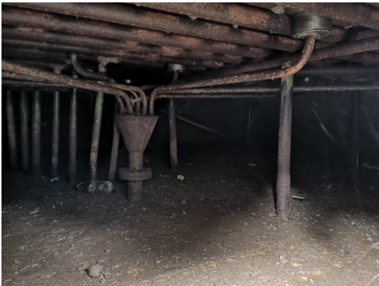
Foto 12 – Detaliu degradări instalații
