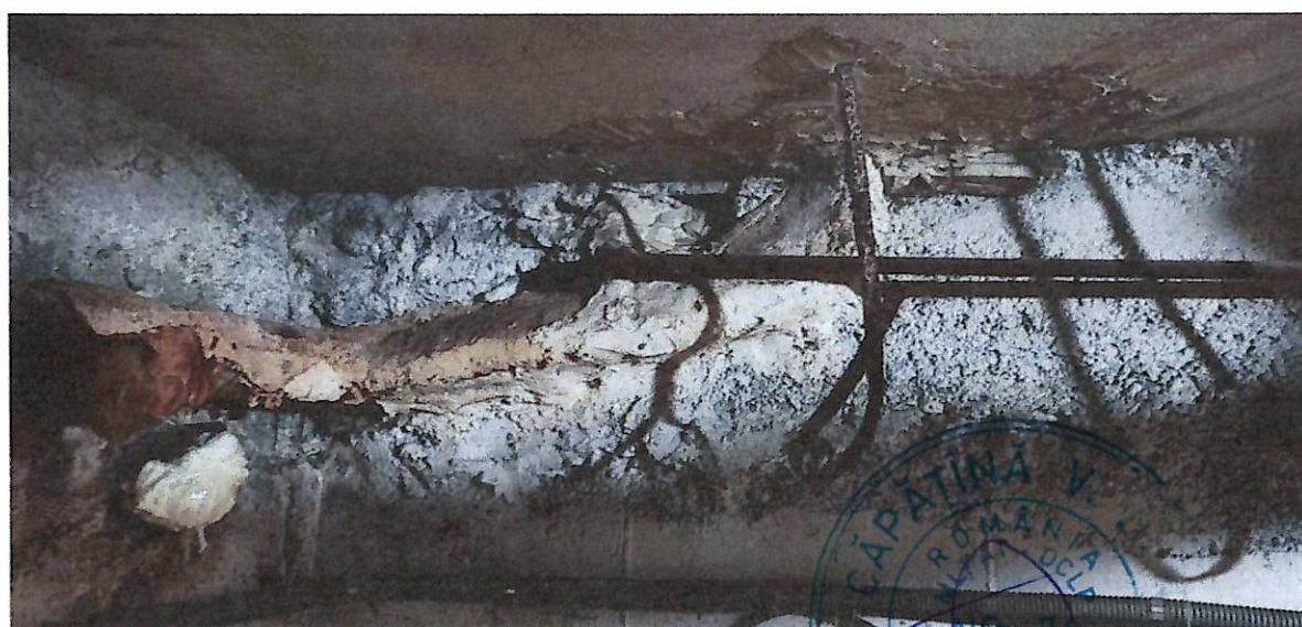
Fig. 9 Degradare placă – armături colmatate
