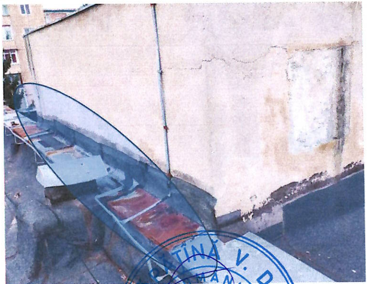
Fig. 13 Degradare pronunțată – atic degradat
