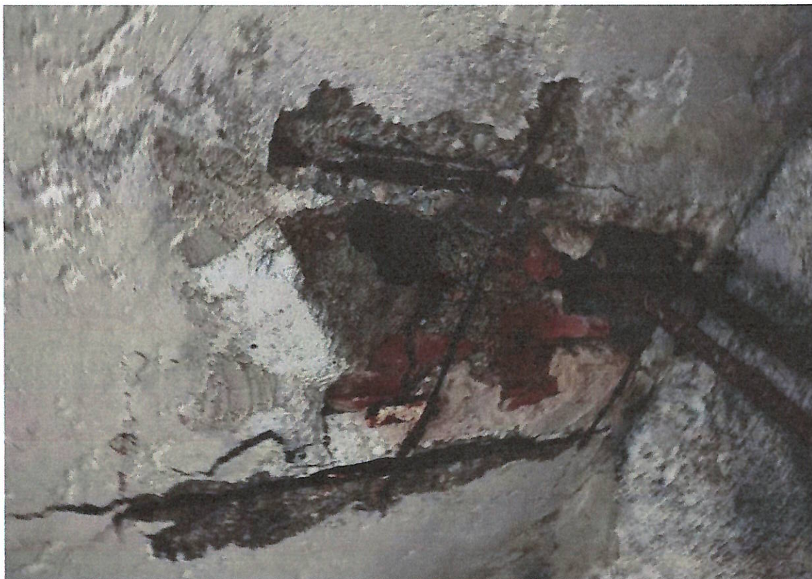
Fig. 8 Degradare placă – armături colmatate
