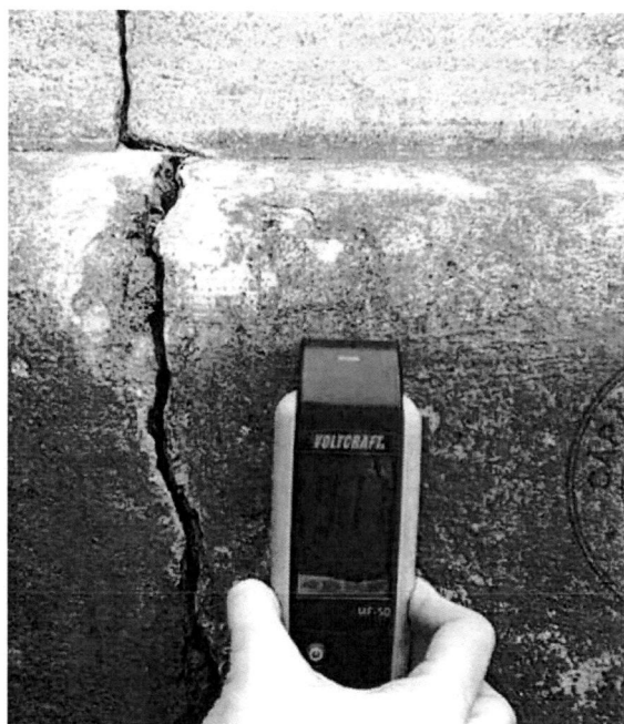
Fig. 1 - Degradări profunde apărute la soclu
